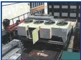
Dry Cooler adiabatique van Spall ABC raccordé à un système de pompe à chaleur
