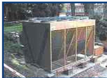
Dry Cooler adiabatique van Spall DVVD raccordé à la climatisation d'un grand immeuble de bureaux
